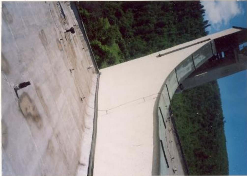
Dom smútku - poškodená strecha Foto č. 11
