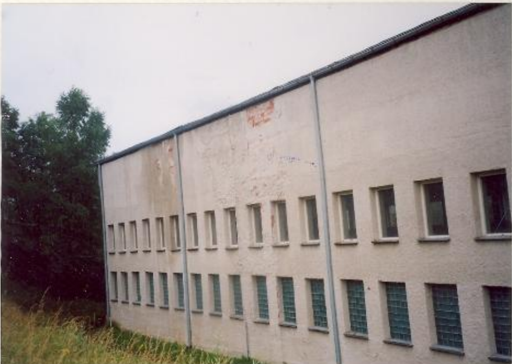
Telocvičňa 13 v - zatekajúca strecha, aj odvodňovú žlaby. Foto č. 9
